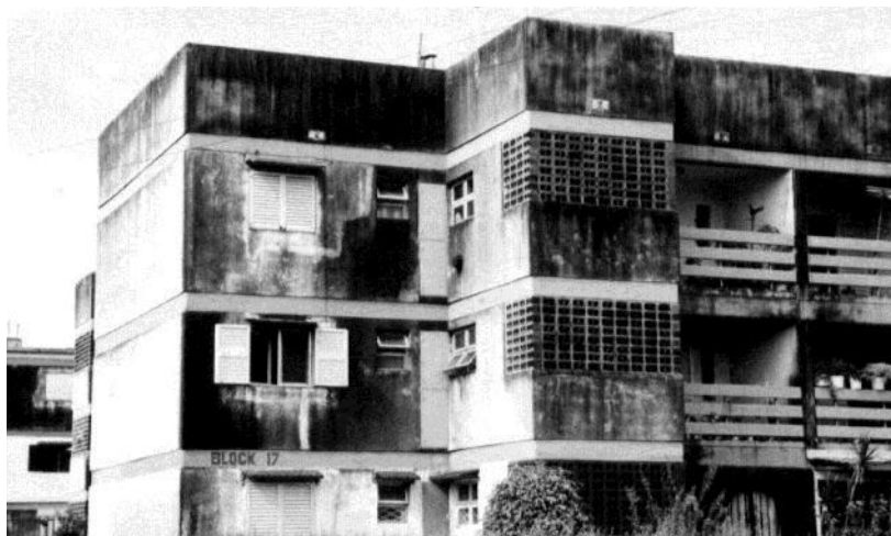
Fig. 8.18 Deterioro de superficie exterior por condensación intersticial y ennegrecimiento por algas y hongos por condensación superficial en fachadas de edificios de viviendas sociales en San Miguel de Tucumán, Argentina. (Foto: C.F.Martinez)
